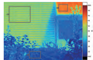
一般材料(底)に比べ 外壁面約6°C低下
